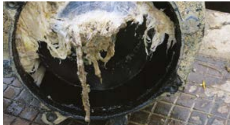
Das Speiseöl verklebt alle Bauteile und muss mühsam entfernt werden.
